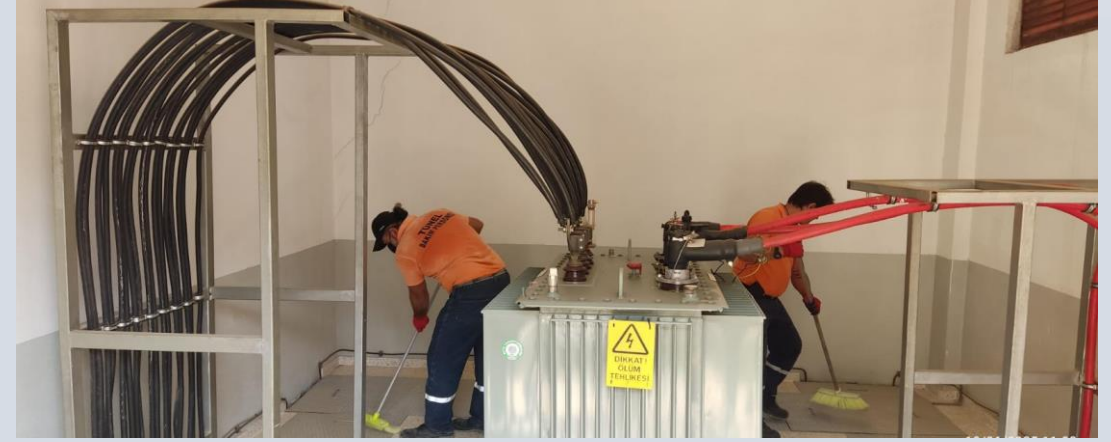
Trafo Yıllık Bakımı
