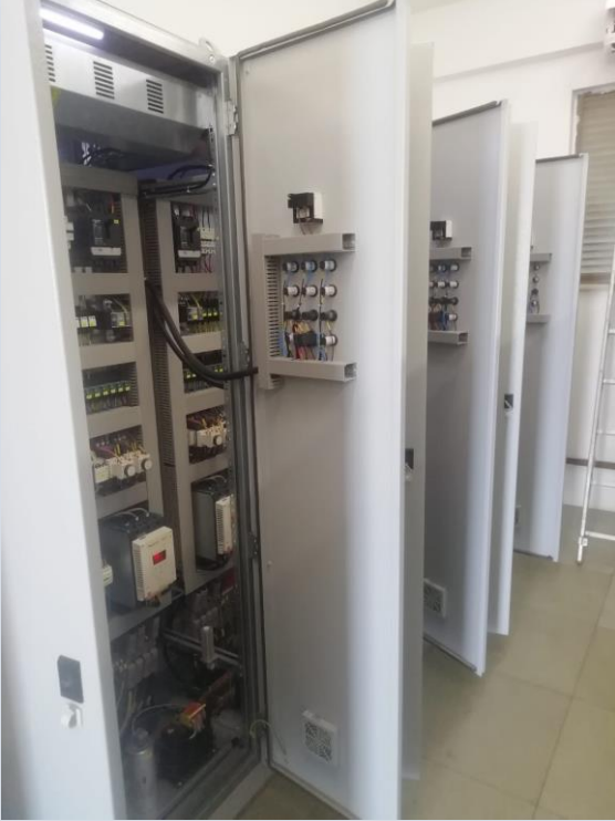
Elektrik Pano Odası (EDB) Aylık Bakımı
