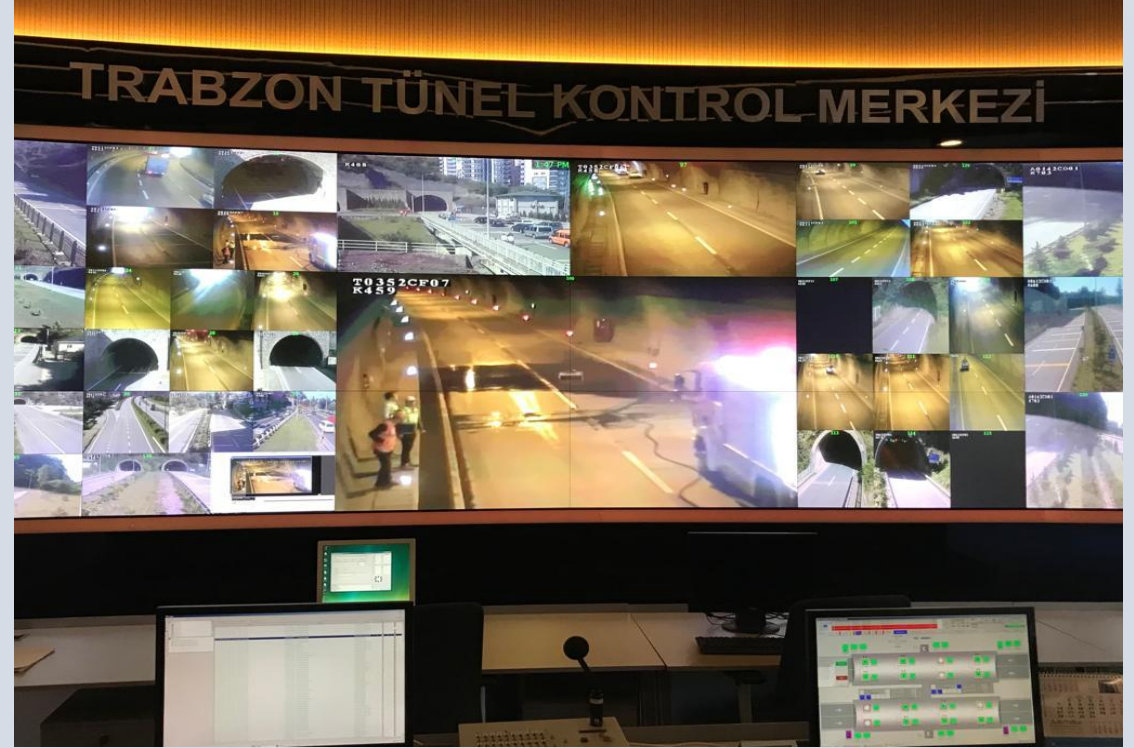
Tünel Kontrol Merkezi İzleme Ekranları
