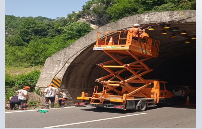
Aydınlatma Armatürü 6 Aylık Bakım ve Kontrolü
