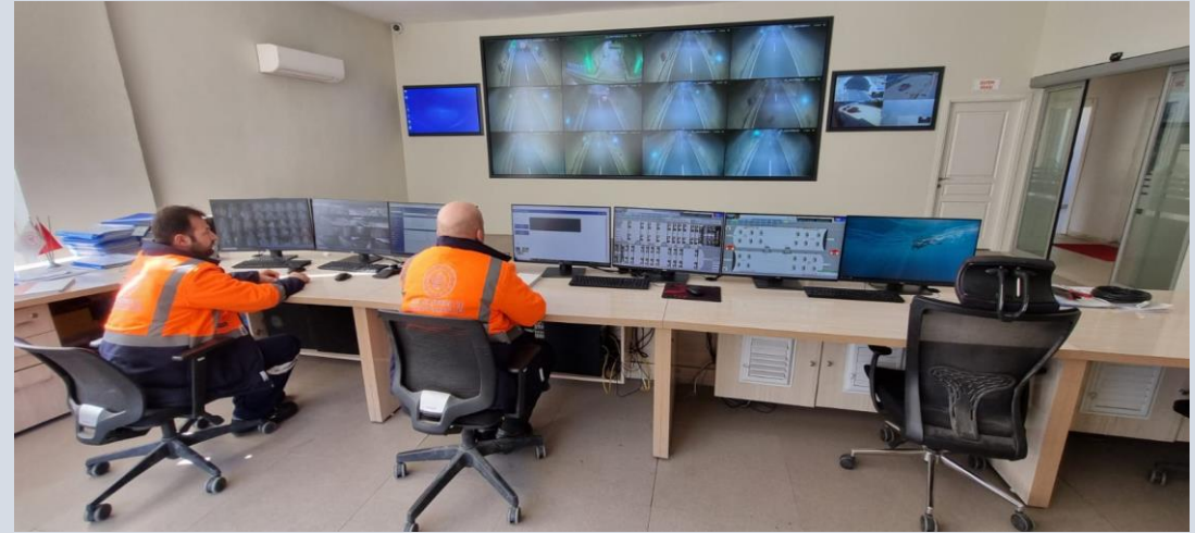
Kahramanmaraş Tünel Kontrol Merkezi
