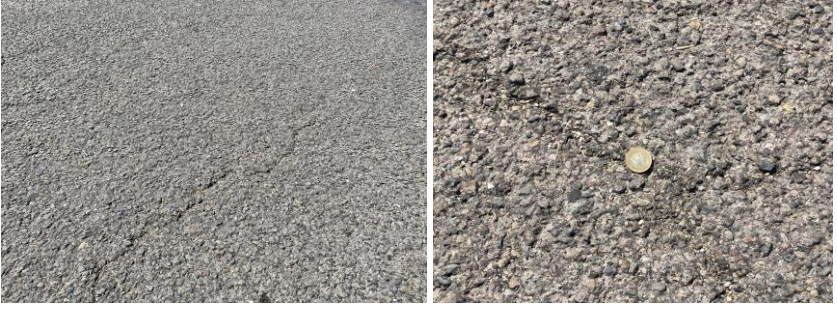
Şekil 1. Mevcut kaplamanın deneme uygulaması öncesindeki genel durumu.
