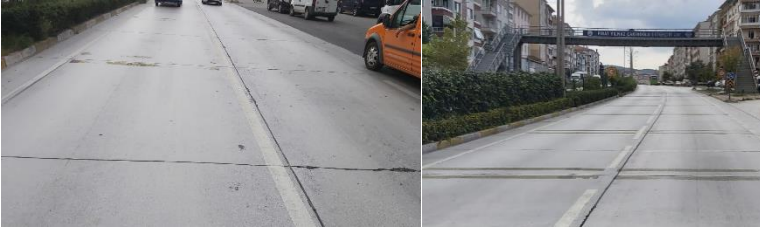
Foto 4. Derz Sökümleri ve Yer Yer Enine Çatlaklar
