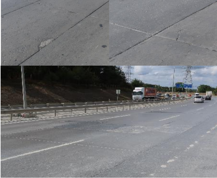
Foto 2. Yüksek Şiddetli Plak Kırılmaları, Derz Kırılmaları, Köşe Çatlamları
