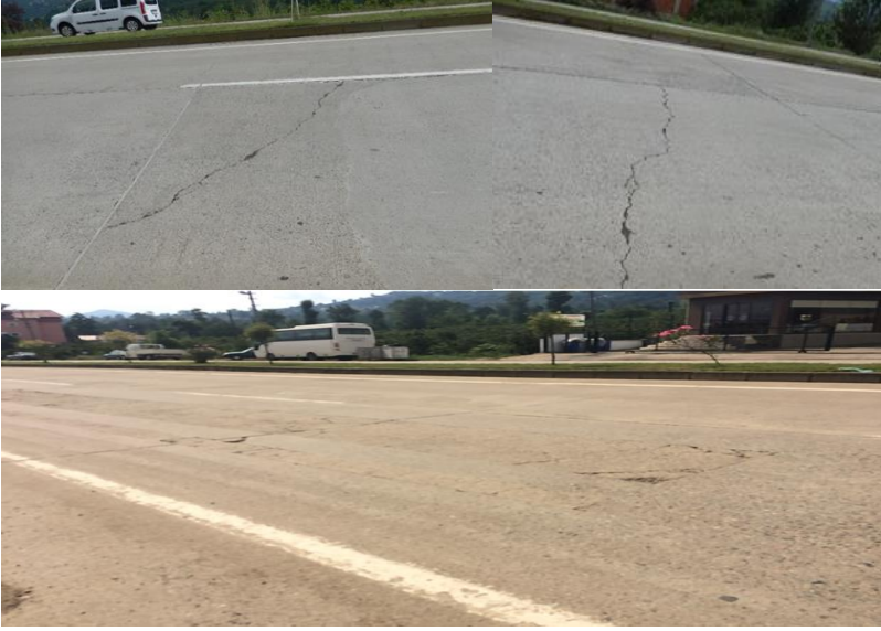
Foto 3. Taşıma Gücü Yetersizliğine Bağlı Bozulmalar, Enine ve Köşe Çatlamları
