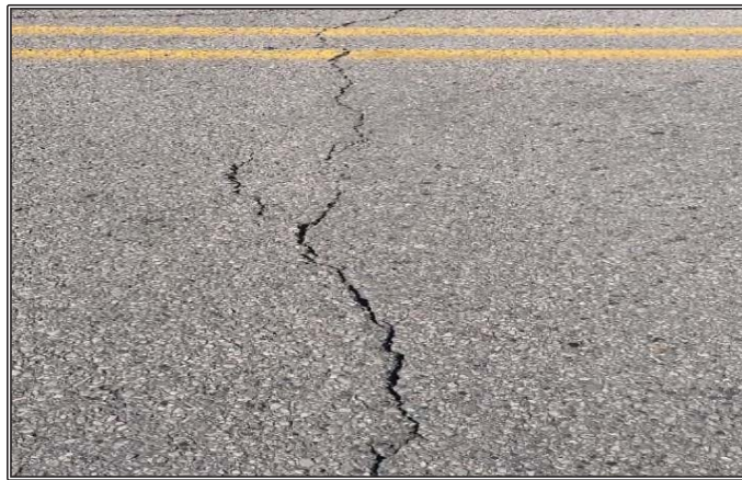
Şekil 3.5. Enine Çatlak (Transverse Cracking)
