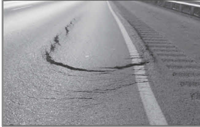
Şekil 3.7. Kayma Çatlağı (Slippage Cracking)
