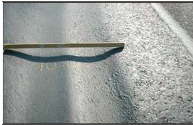
Şekil 3.9. Tekerlek İzinde Oturma (Rutting)
