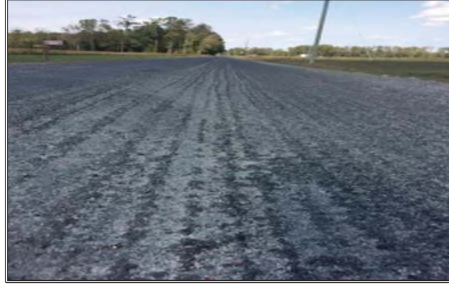
Şekil 3.18. Boyuna Çizgisel Agrega Kaybı (Longitudinal Streaking)
