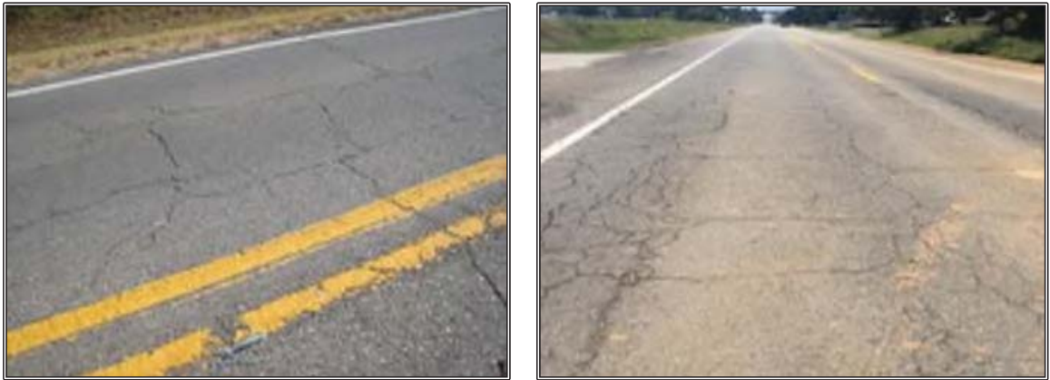
Şekil 3.2. Blok Çatlak (Block Cracking)
