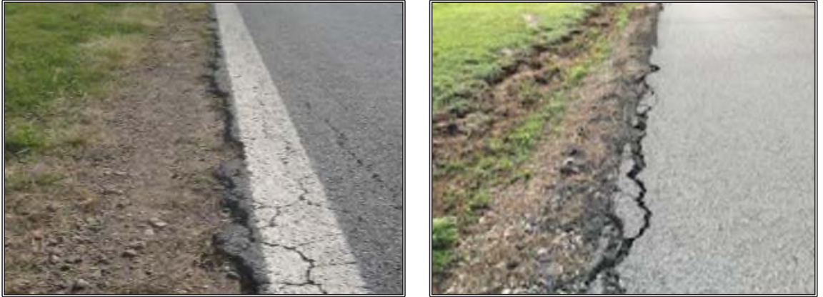
Şekil 3.3. Kenar Çatlağı (Edge Cracking)
