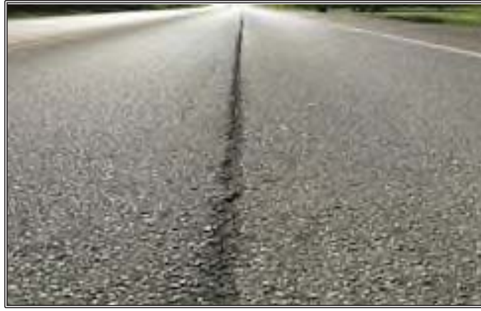
Şekil 3.4. Boyuna Çatlak (Longitudinal Cracking)
