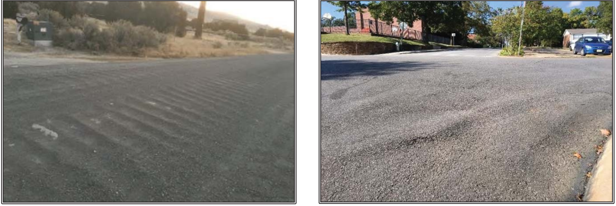
Şekil 3.8. Ondülasyon ve Yığılma (Corrugation and Shoving)
