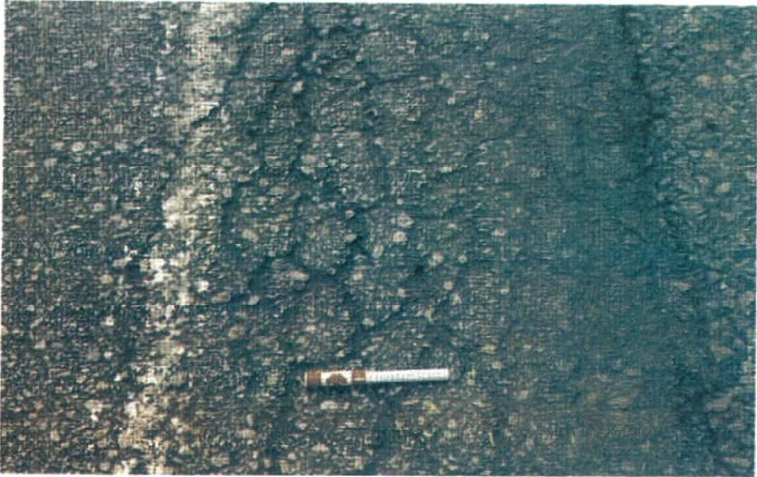
Yüksek Şiddette Kenar Çatlağı
