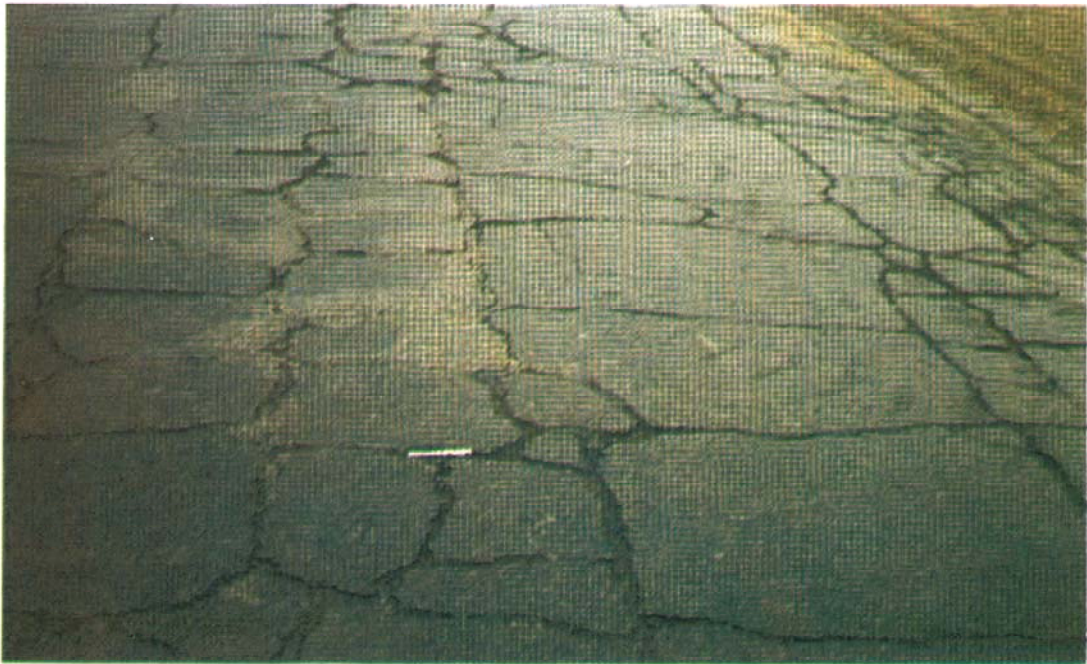
Yüksek Şiddette Blok Çatlak
