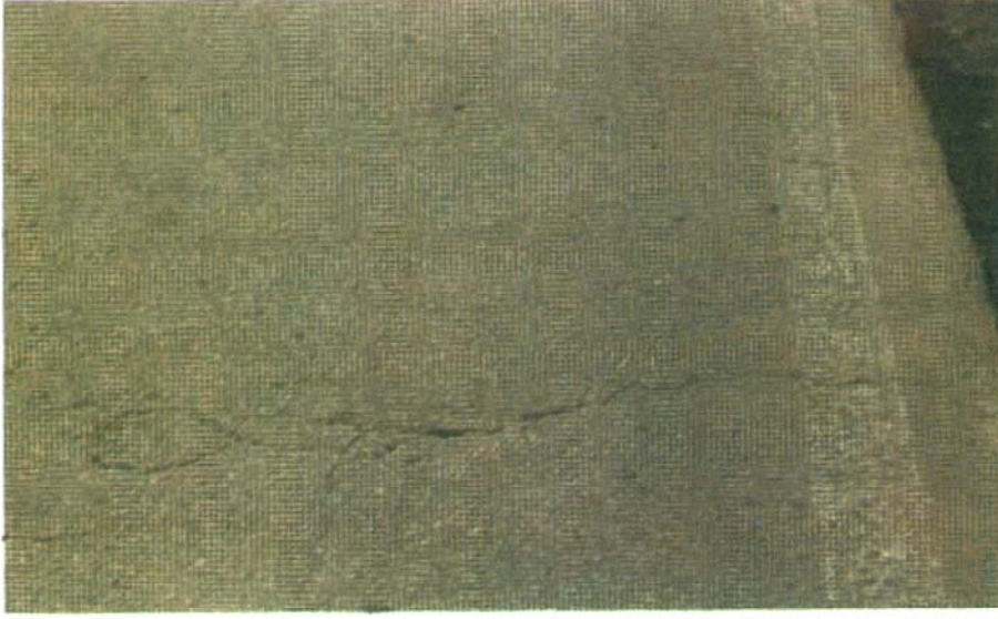
Hafif Şiddette Enine Çatlak
