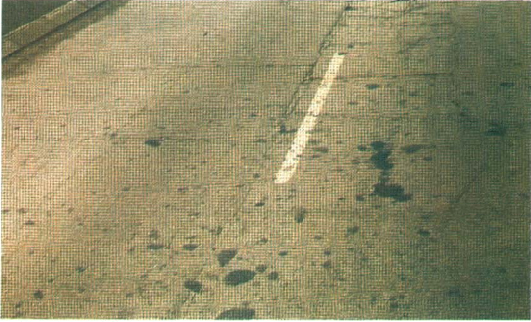
Orta Şiddette Blok Çatlak
