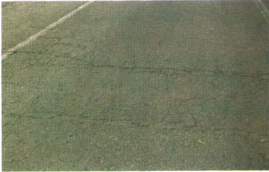
Orta Şiddette Enine Çatlak
