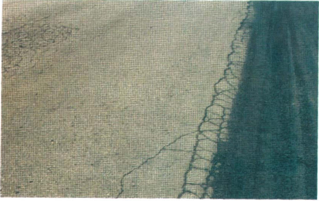
Orta Şiddette Kenar Çatlağı
