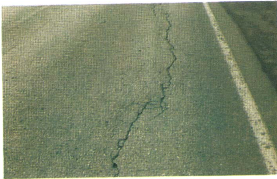
Yüksek Şiddette Boyuna Çatlak
