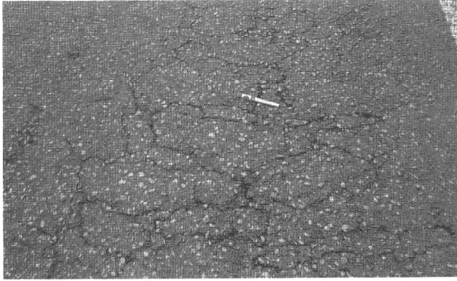
Orta Şiddette Timsah Sırtı Çatlak
