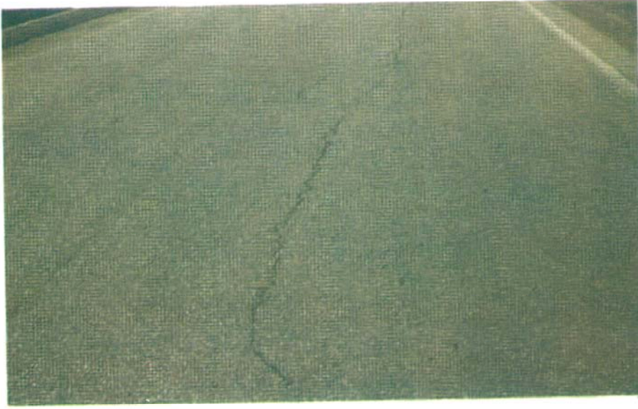
Hafif Şiddette Boyuna Çatlak
