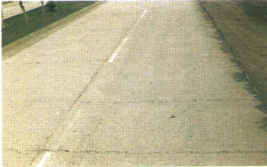
Yüksek Şiddette Enine Çatlak
