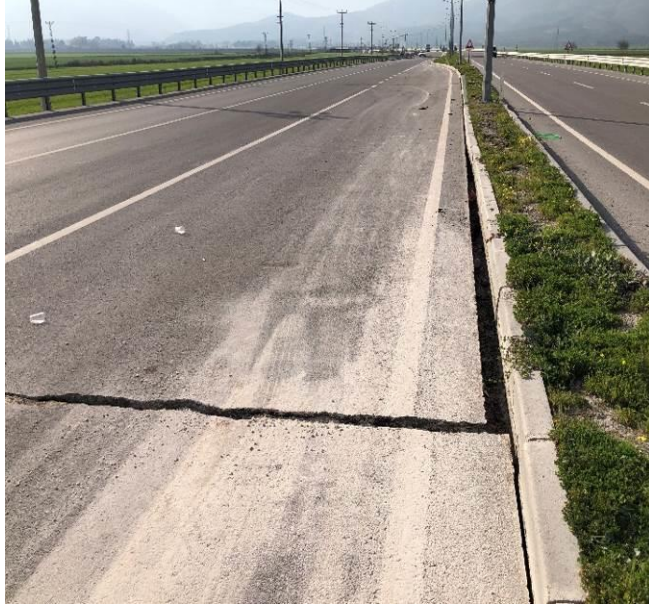
Deprem Nedeniyle Üstyapıda Oluşan Hasarlar
